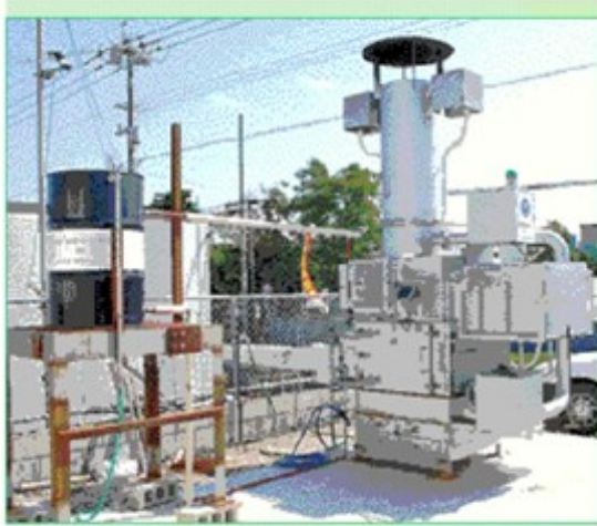
右側がチリメーサー。1時間あたり45kgの廃棄物の処理が可能。左側のドラム缶部分は廃熱利用給油設備。チリメーサーとパイプでつながっており、焼却熱で沸かした湯を貯溜しておける。「湯を多く使う病院やホテル、老健施設等にもお薦めしたい」と福富さん。
